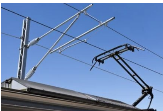
電車線とパンタグラフ
