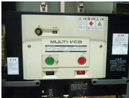
真空遮断器(VCB)
