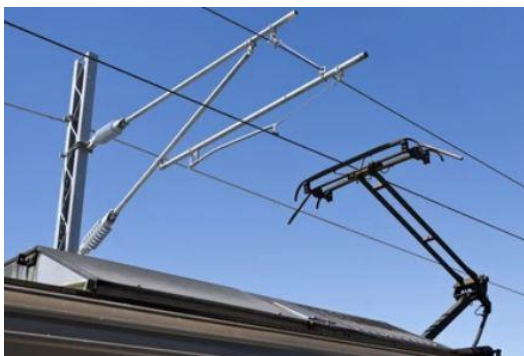
電車線とパンタグラフ
