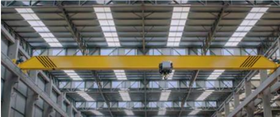
天井クレーン
